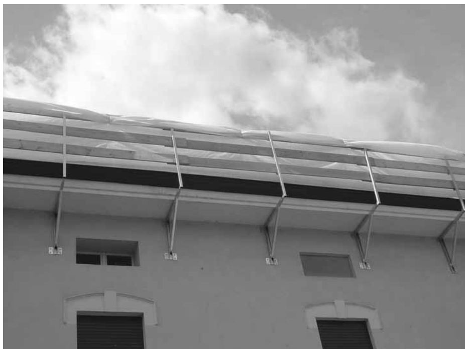
Sistemi provvisori di protezione bordi tetti
